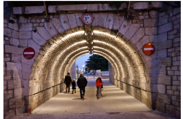
Eclairage indirect de la voûte du tunnel avec des 4040 - Luminy 4 à faisceau elliptique.
